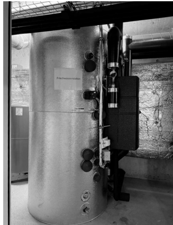
Warmwasserspeicher Mehrfamilienhaus beheizt mit Wärmepumpe
